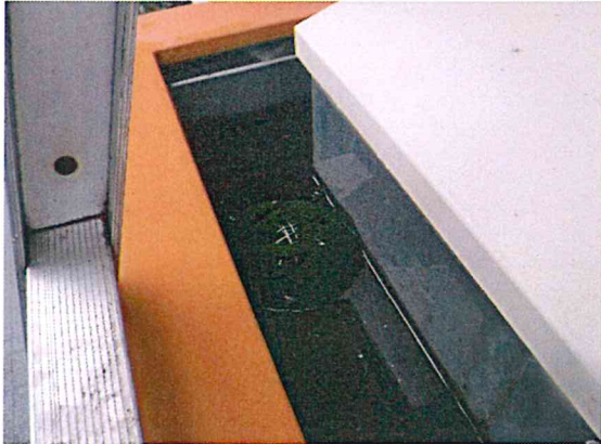
ストレーナー詰まりによる排水不良
