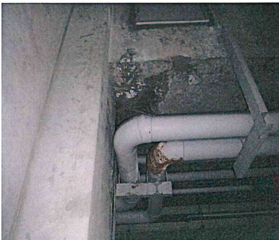
スラブクラックより漏水
