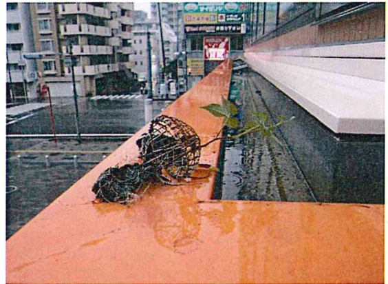
ストレーナー詰まり
