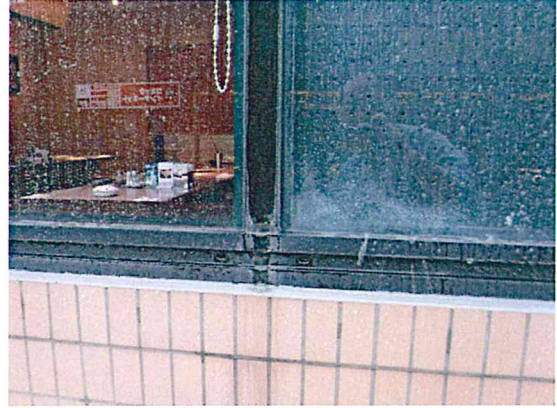
漏水箇所上部
