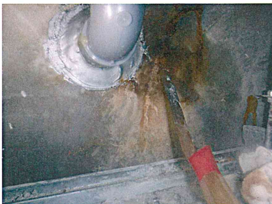
止水チューブ廻りより染み出ている
