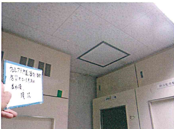
数日後漏水停止しておらず
