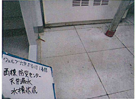
壁を伝い床 水損
