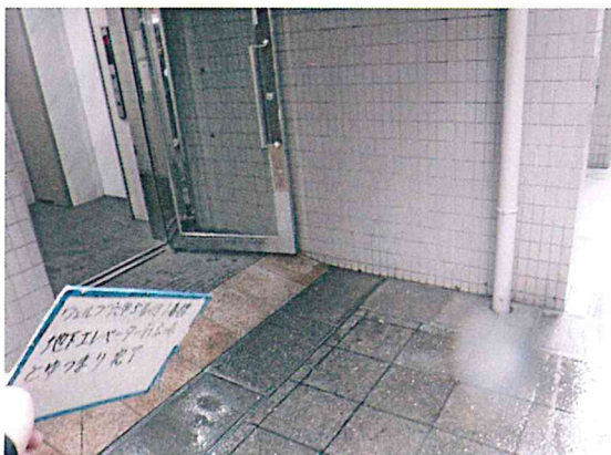
冠水状況解消
