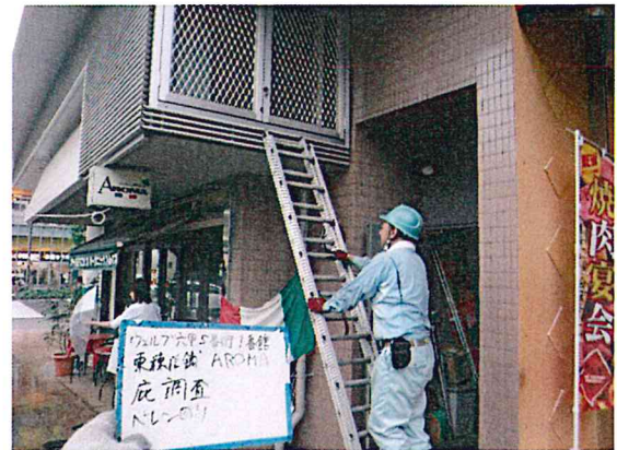
清掃後、エアコン室外機スペースより漏水
