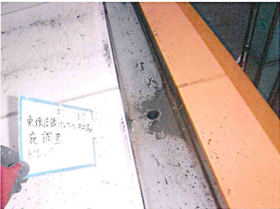
漏水箇所、店舗117詰まりなし(ストレーナー欠損)
