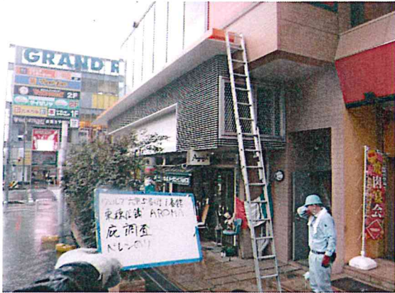
店舗123 排水不良
