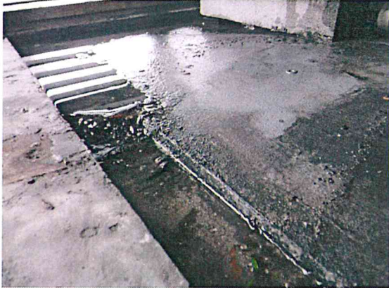
排水路泥詰まり
