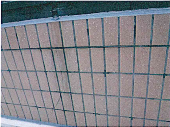
サッシ廻り排水集中箇所にクラックあり
