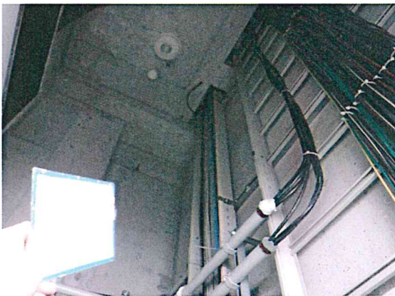
天井の高い位置より漏水
