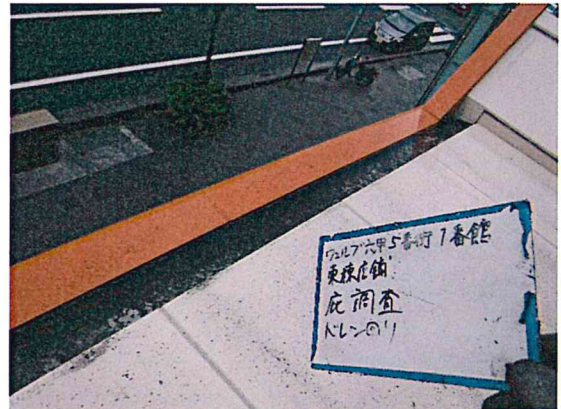
店舗112 排水詰まり
