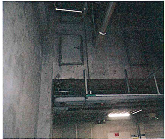
換気ダクトスペースより漏水
