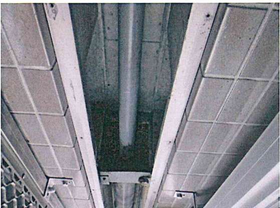
配管エア一抜き樋受け
