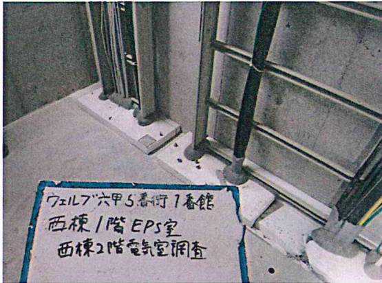
漏水箇所上部 電気室
