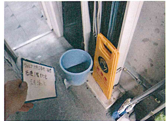
排水経路がないためバケツ対応
