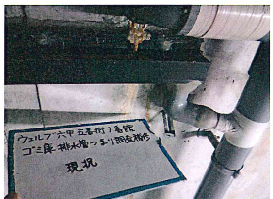
原因箇所(石灰化による排水詰まり)
