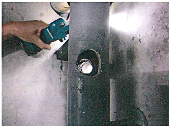
排水系統復旧
