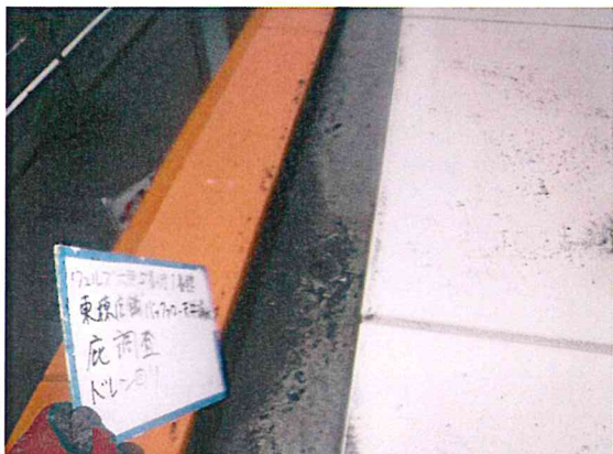
店舗115排水管詰まりあり(ストレーナー無し)
